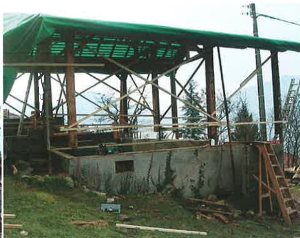
Fin janvier, il ne reste en place que la structure du chalet
