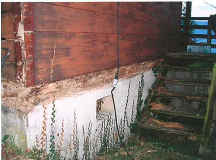
On voit ici très nettement l'état de pourrissement de la base, une fois enlevée la pellicule extérieure du bardage bois.
